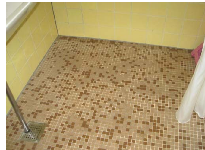
Løse fliser på gulv og vægge.
