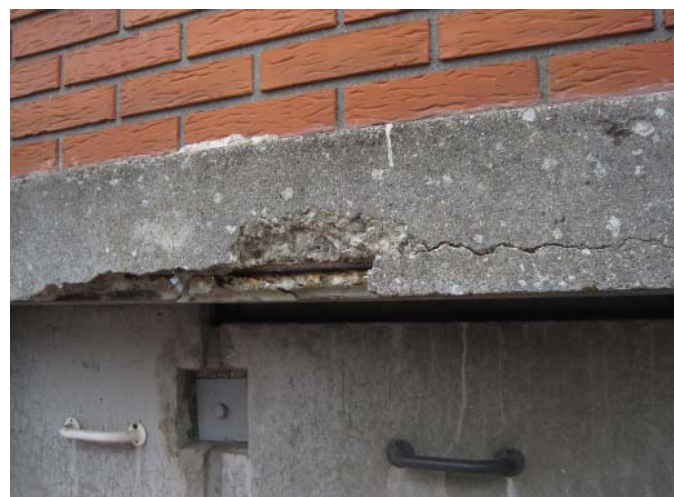
Skader på facaderne.
