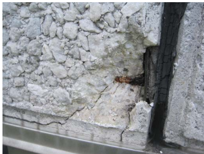
Betonskader på altanerne.
