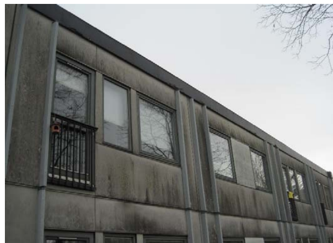
Vinduer og døre er nedslidte (blok
