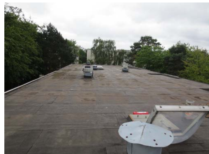
Nedslidte tage (blok 1-5).
