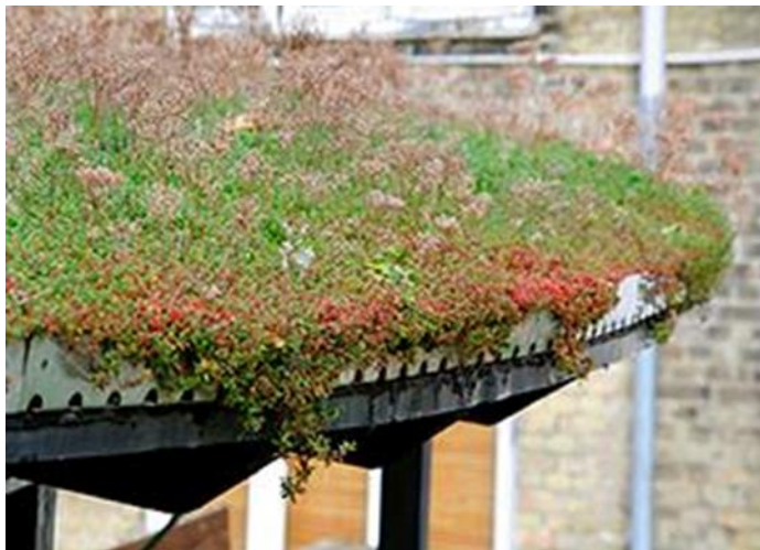
Figur 13 Reference Sedumtag. Kilde: Frederiksberg Forsyning
