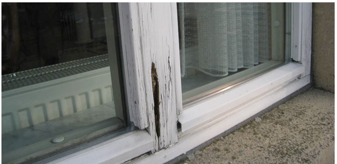
Råd i lodpost i sydvendt vindue
