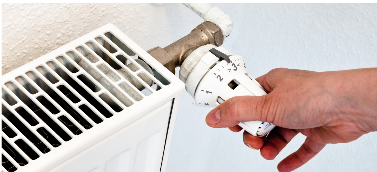
En central styring af energiforbruget i de kommunale bygninger sikrer brugernes indeklima og en energirigtig drift.
