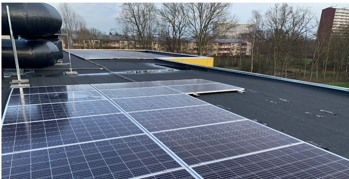
Solcelleanlæg på Børnehuset Kæret.
